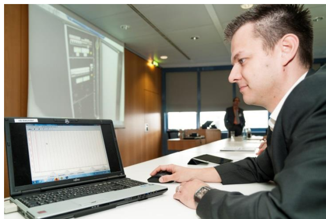
Bernd Wunder, Leiter der Gruppe DC-Netze in der Abteilung Energieelektronik des IISB, bei der Inbetriebnahme des DC-Netzes zur Gleichstromversorgung
